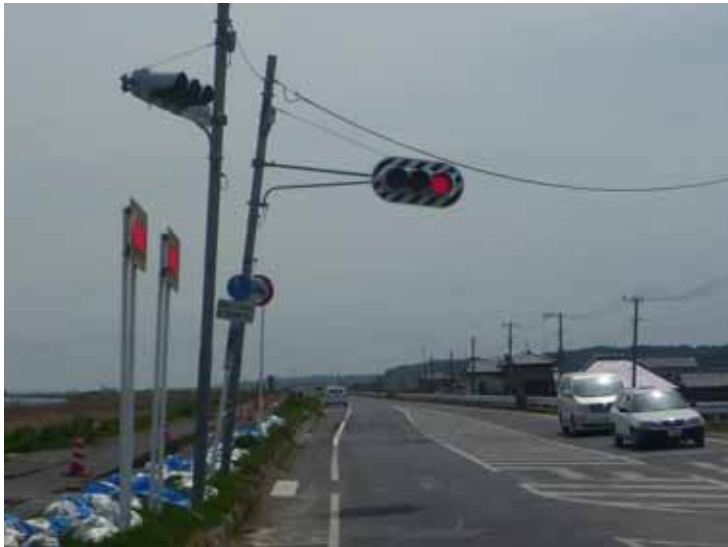
千葉県香取市 (信号柱+基礎不明)-8°傾斜
